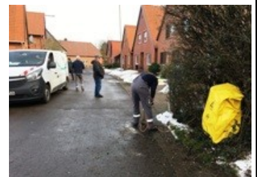
↑ Stromkasten mit Haube abgedeckt
